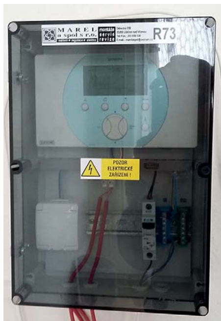
↑ Centrální jednotka s odečítáním údajů o spotřebě energií
