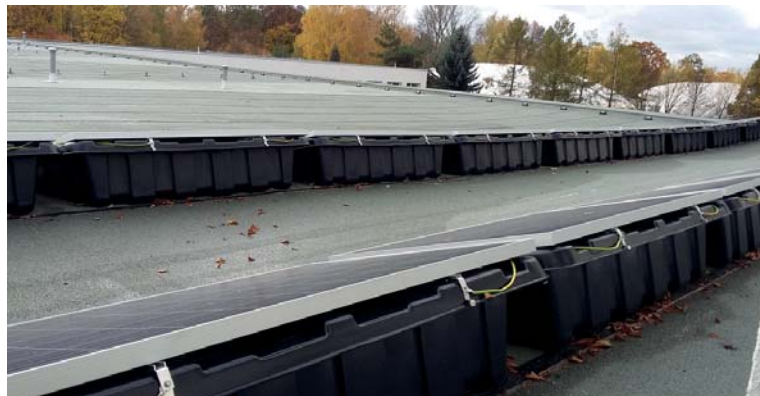
↑ Instalované fotovoltaické panely o celkovém výkonu 5,2 kWp
