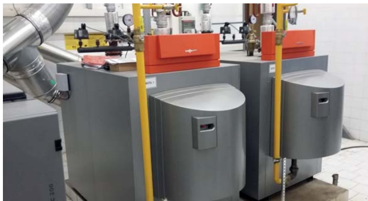
↑ Nové kondenzační kotle Viessmann
