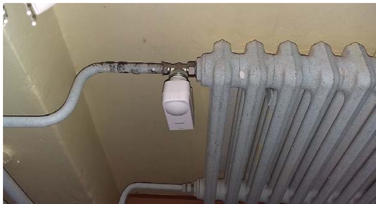
↑ Namontované termoelektrické ventily a hlavice s bezdrátovým ovládáním na stávajících radiátorech
