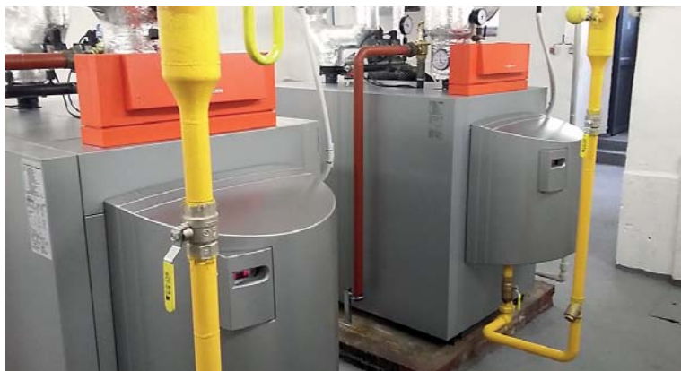
↑ Nové kondenzační kotle Viessmann
