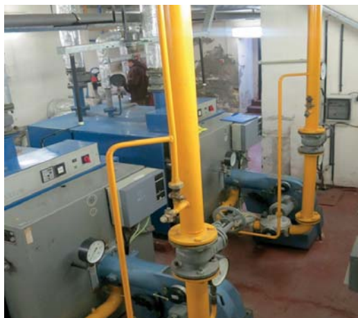
↑ Původní kotelna s atmosférickými kotli
